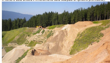
foto evidenza sulla destra il rinverdimento provvisorio della scarpata finale di scavo, al centro in riporto in corso e sulla sinistra il rinverdimento delle scarpate di ripristino provvisorie);
